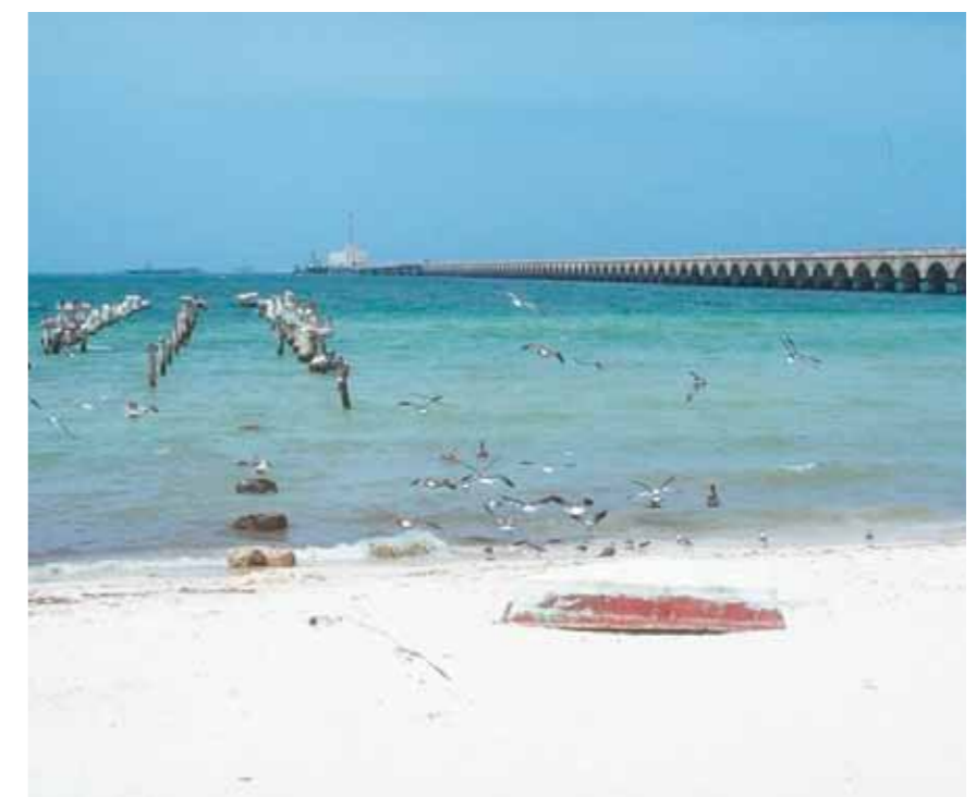
Piren till höger är armerad med rostfritt och står kvar efter många år i aggressiv miljö med vatten, värme och salt. Piren till vänster fick ett betydligt kortare liv på grund av materialval.
